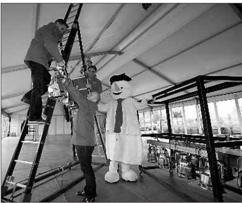
• Onder het toezien oog van de sneeuwman bouwen ijsmeesters Marc Kloppenburg, Mark de Jong en Ronald Cordes van het Vlaardingse Deltahotel een kunstijsbaan op. De bouw ervan is gisteren begonnen en de opening wordt vrijdagmiddag verricht door voormalig hardrijdster Barbara de Loor. De komst van de baan, die vijf weken blijft liggen, is mogelijk gemaakt door het bedrijfsleven. General manager Cordes van het hotel vermoedt dat de schaatsbaan in een grote behoefte gaat voorzien. „In veel gemeenten is de kunstijsbaan geschrapt, omdat de kosten vanwege de bezuinigingen niet langer zijn op te brengen.” Het geld dat de komende vijf weken met de ijsbaan wordt verdiend, gaat naar een goed doel: het Hospice Nieuwe Waterweg Noord, waarvoor vandaag in Vlaardingen de eerste paal wordt geslagen. FOTO: ROEL DIJKSTRA
